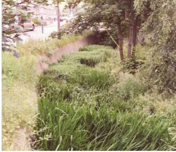
Şekil 3.2: Beton kanal içine alınan su yolunun üzerinde oluşan yeşil doku
