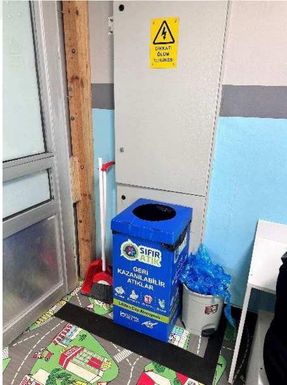
Görsel 4.27: İvat Turhan Anaokulu Elektrik Panosu
