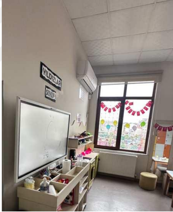
Görsel 4.22: Esa Karadolap Anaokulu Havalandırma ve Isınma Sistemi Olarak Klima
