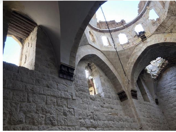
(Şekil 3.53):Vekil Evinin Hasarlı Kubbesi (Ocak-2019).
