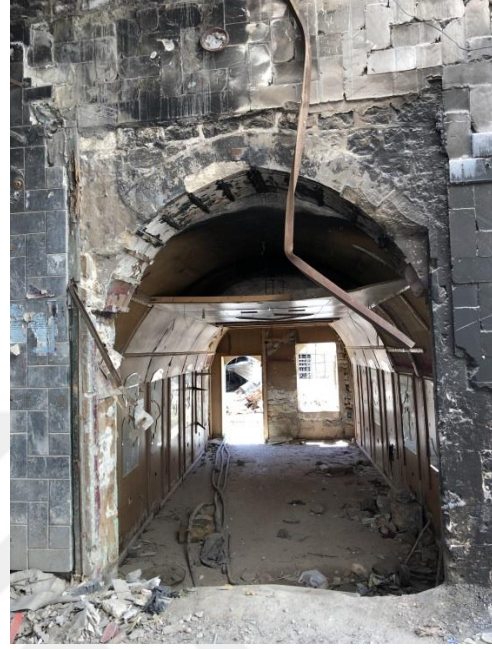
(Şekil 3.77):Kapalı Çarşıda Hasarlı Dükkan (Nisan-2018).
