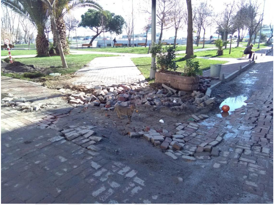
Şekil 4.16: Kazı çalışması sonrası deforme olmuş üst kaplama elemanları (İstanbul- Fatih)
