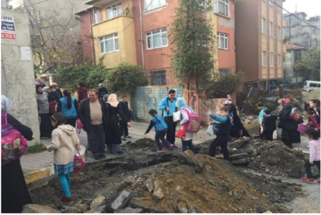
Şekil 4.13: Güvenlik Önlemi Alınmamış Altyapı Kazı Çalışması
