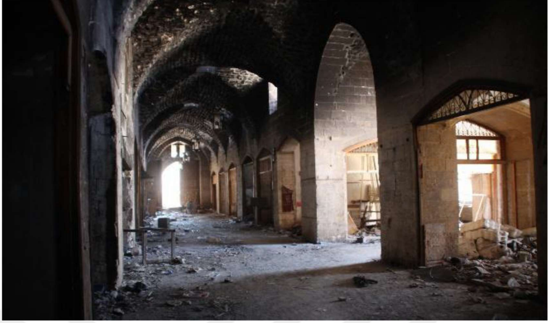
Şekil 4.8: Halep, Suriye Khan Al-Shouna’da Hasar
