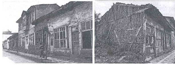
Resim 3 ve Resim 4: Ogeneral Aytaç Yaman Caddesi'ndeki metruk yapılar
