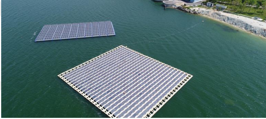
Şekil 4.7. Büyükçekmece Gölü yüzer güneş enerjisi santrali
