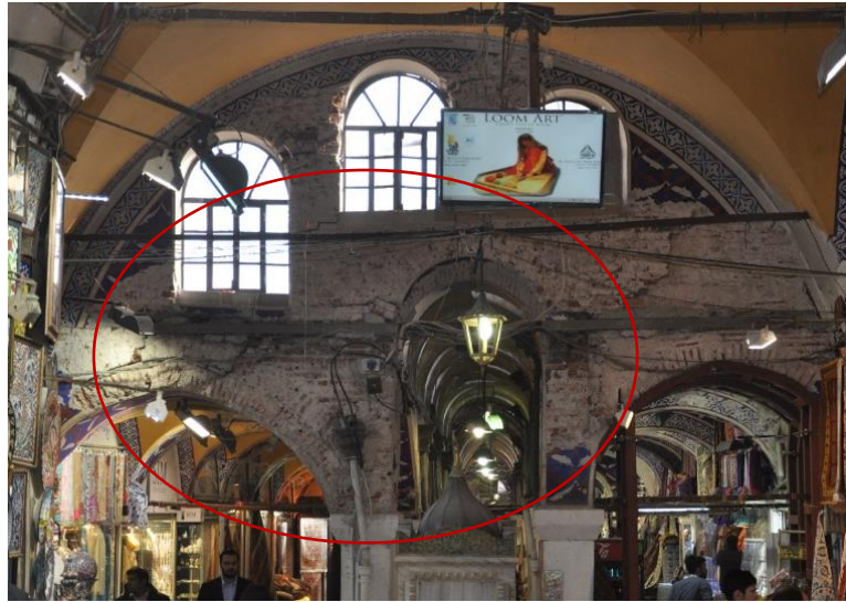
Resim 5.67: Sokaklardaki Sıvalı Yüzeylerde Dökülmeler (Kişisel Arşiv, 2019)
