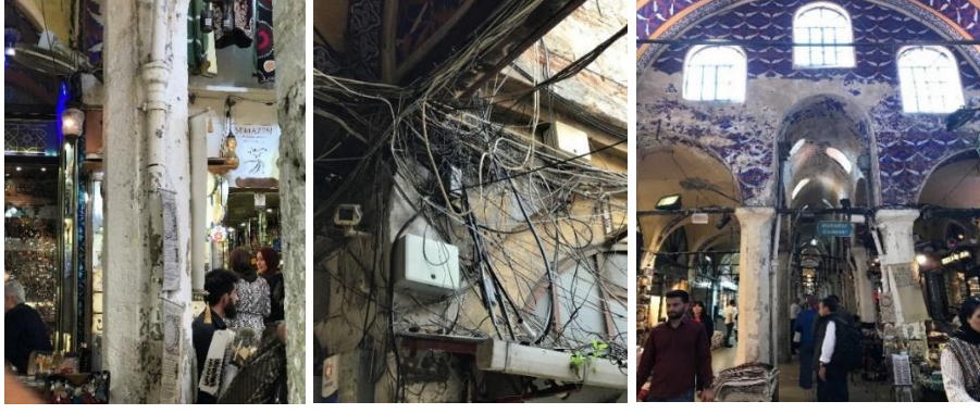
Resim 5.59: Kapalıçarşı Duvarlarında Kablolar (Kişisel Arşiv, 2019)
