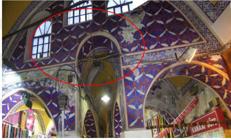
Resim 5.66: Sokaklardaki Sıvalı Yüzeylerde Dökülmeler 2019 (Kişisel Arşiv)
