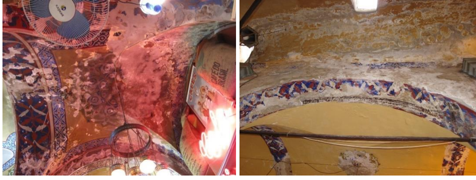
Resim 5.65: Sokaklardaki Sıvalı Yüzeylerde Dökülmeler (Kişisel Arşiv, 2019)
