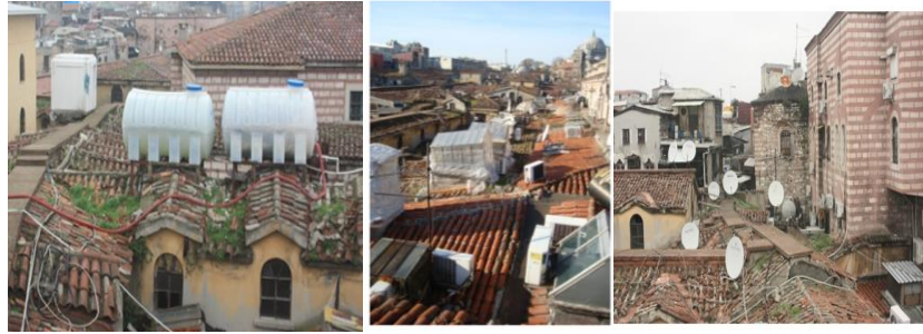
Resim E.75: Kapalıçarşı Onarım Öncesi Çatı Durumu; Su depoları, Kablolar, Antenler ve Klimaların Oluşturduğu Hasarlar
