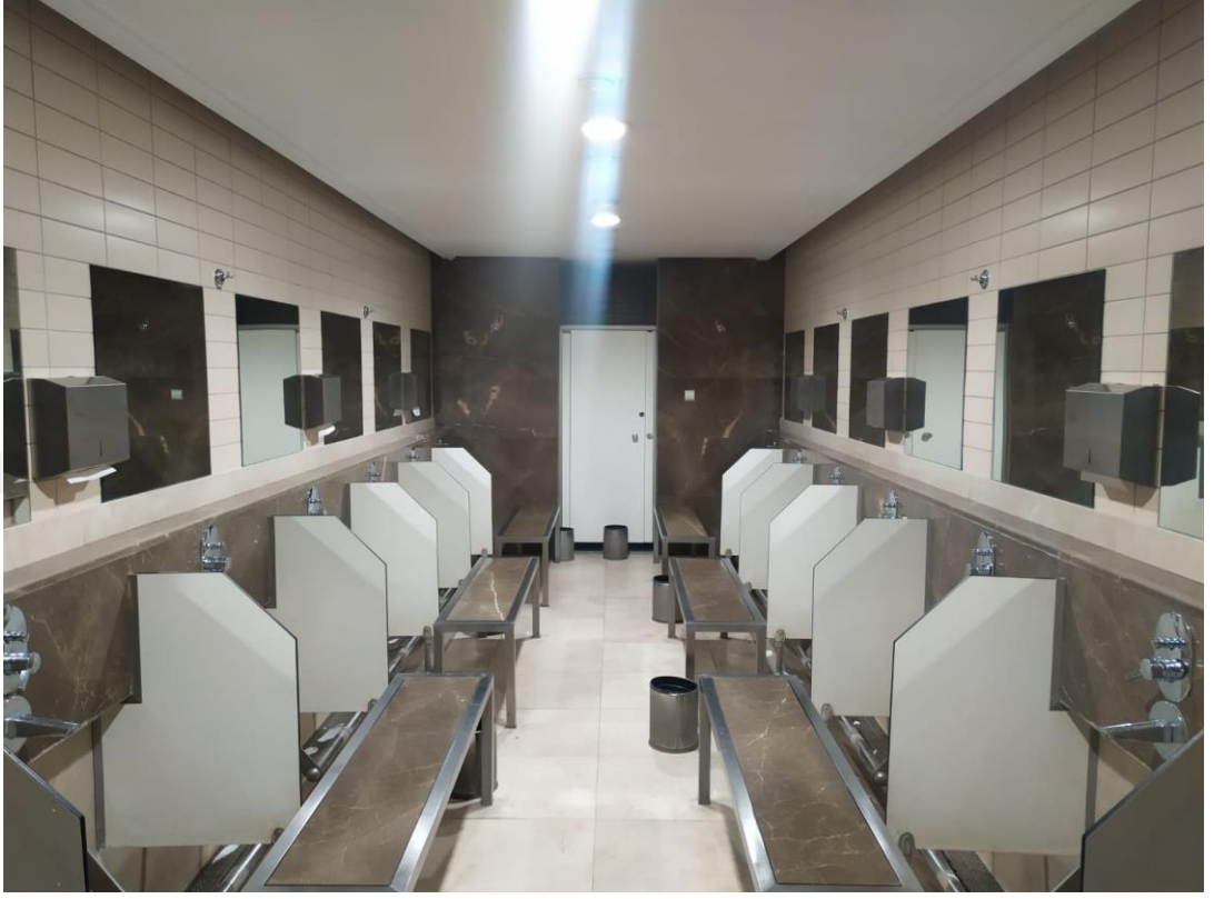
Resim 2. 29: İhsan Doğramacızade Camii Abdest Alma Mekânı Kompakt Seperatör, Çankaya / Ankara
