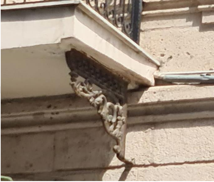
Şekil 5.14: Çalışma alanında bulunan korozyon örneği
