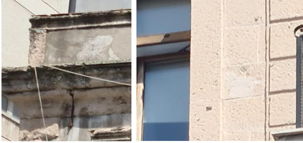
Şekil 5.12: Çalışma alanında bulunan kabuklanma ve kavlanma örneği
