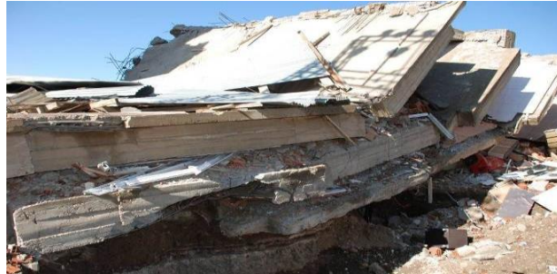
Şekil 7.82: Bodrumsuz yapıda hasar, tekil/sürekli temel sistemi örneği, Kaynak: (YTÜ 2011).
