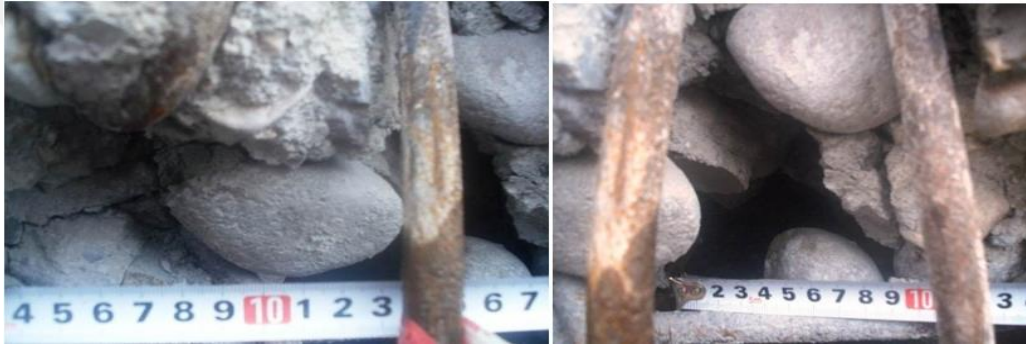
Şekil 7.79: Betonda granülometriye uymayan agreganın oluşturduğu boşluk
