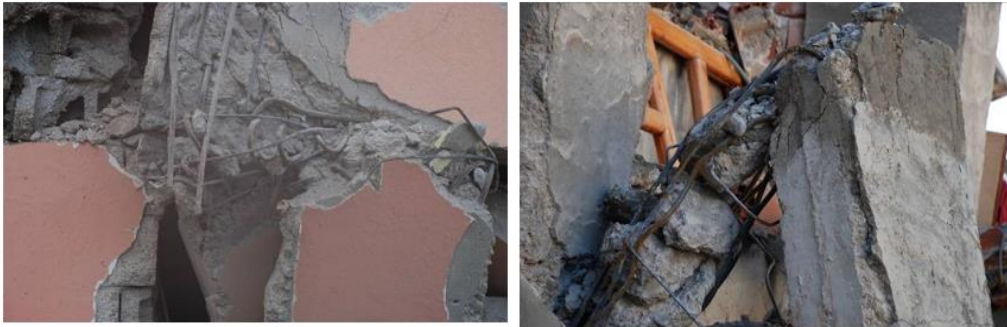
Şekil 7.84: Kuvvetli kiriş-zayıf kolon oluşumu
