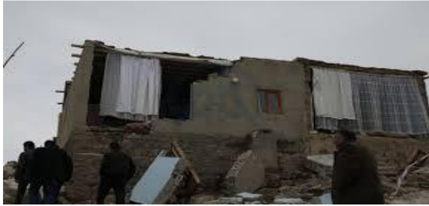
Şekil 7.90: Van Gedikbulak Köyü, briket evde deprem hasarı
