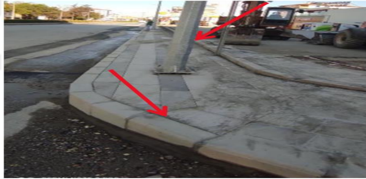
Şekil 7.108: Eski kaldırımın yerine yapılan engelli rampası olmayan kaldırım, semaver kavşağı-2021
