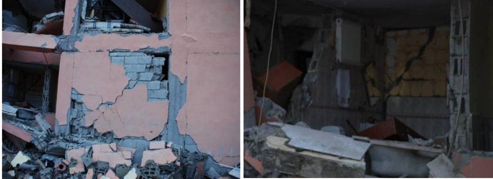
Şekil 7.86: Dolgu duvar hasarları
