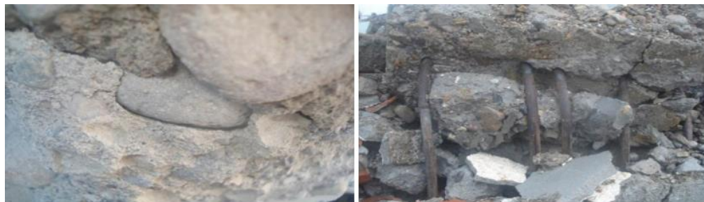
Şekil 7.80: Çimento hamuru-agrega ara yüz çatlağı ve betondan sıyrılan düz inşaat demiri
