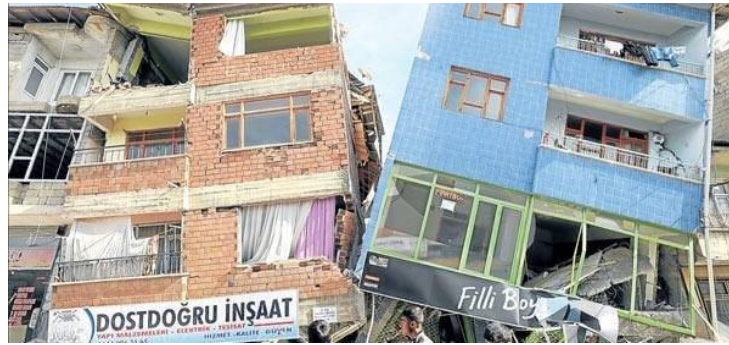
Şekil 7.75: Erciş Camii-Kebir Mahallesi çarpışma/çekiçleme etkisiyle yıkılan yapılar
