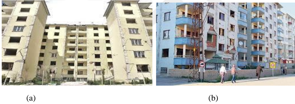
Şekil 7.15: Depremde ağır hasar gören yap-sat yapı örnekleri (a)- Halilağa Mahallesi (b)-Şerefiye Mahallesi
