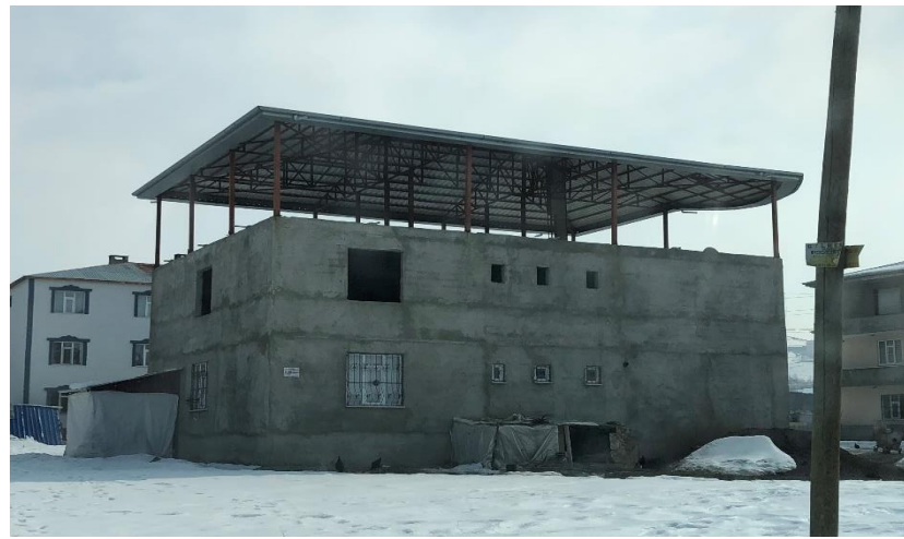
Şekil 7.42: Van kent merkezi ve mahallelerde eksik, riskli yapı örnekleri
