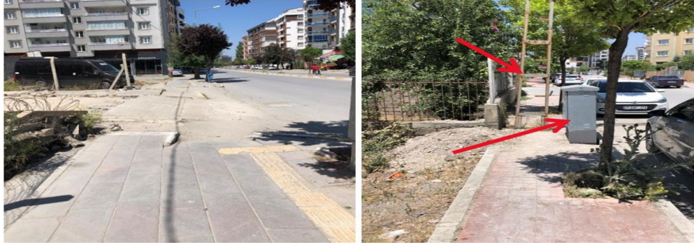
Şekil 7.110: Van Ali Paşa Mahallesi, standart olmayan kaldırım örnekleri
