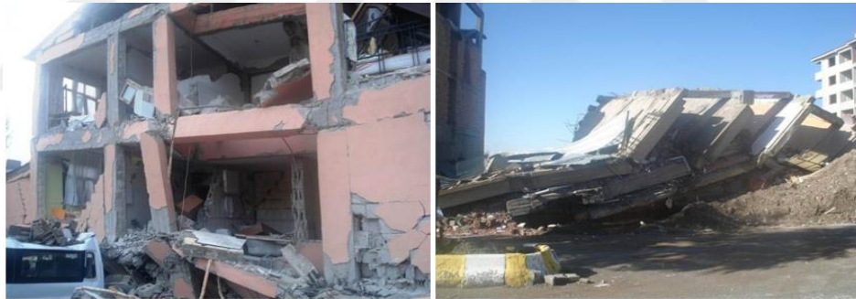
Şekil 7.77: Erciş ağır hasarlı betonarme-karkas yapı örnekleri
