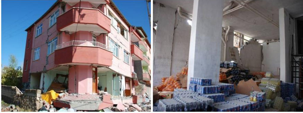
Şekil 7.87: Yapılarda tasarım hatalarına örnek (Van-Erciş)
