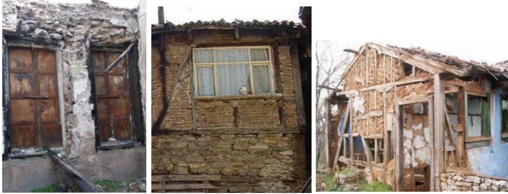
Şekil 3.38: Kimyasal bozulmalar / Çatlak oluşumları
