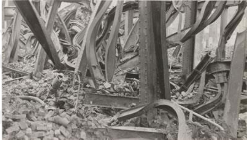
Şekil 4.6: Çelik kolonların deformasyonu
