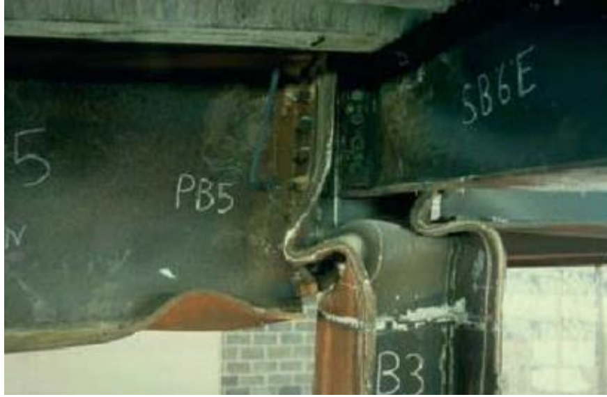
Şekil 4.11: Korumasız çelik kolon ve kirişte yangın sonrası görülen hasarlar
