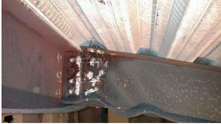
Şekil 4.10: Yüksek ısı etkisiyle ovalleşen cıvata/somun boşluğu
