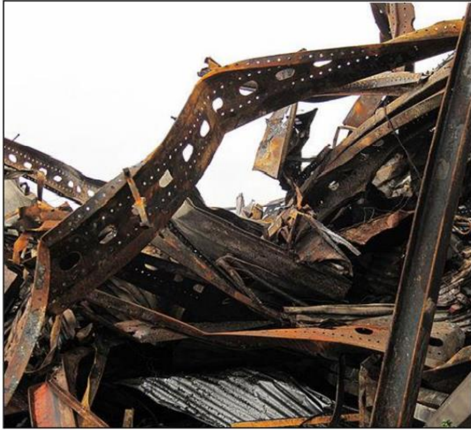
Şekil 4.9: Çelik kirişlerde kalıcı eğilme ve deformasyon oluşumları
